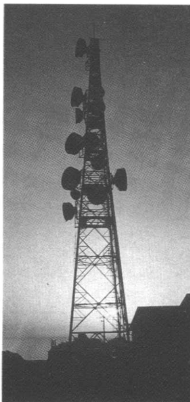
Ponte radio di Monte Limbara.
