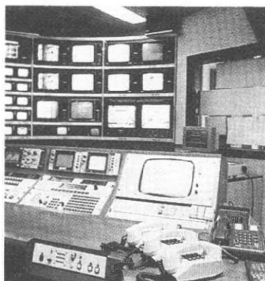
A sinistra, apparecchiature per la supervisione ed il controllo tecnico dei programmi televisivi. In alto, uno studio televisivo.
